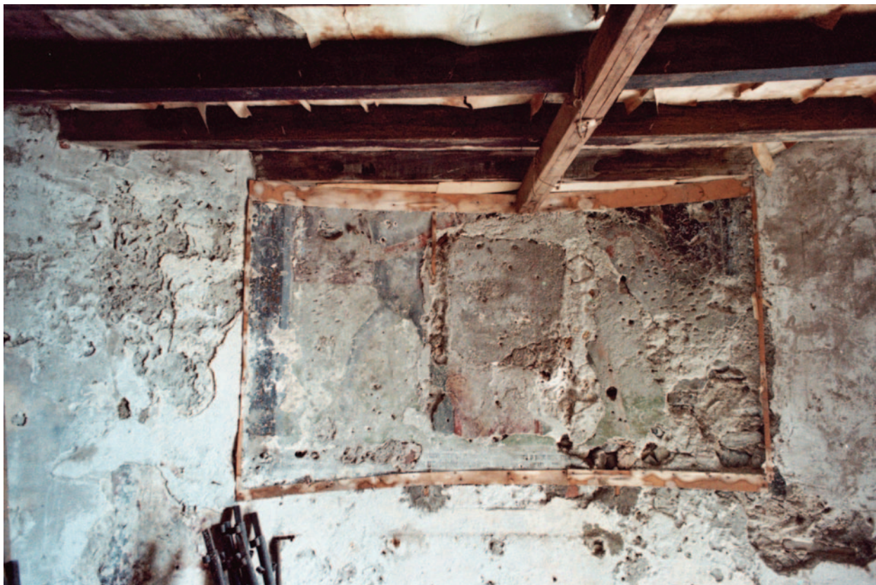
Fig. 9. Lovere, San Martino. Abside durante i lavori di restauro (foto Luigi Cottinelli).
